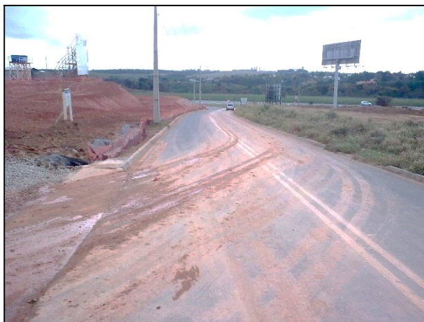
Figura 1: Saída de sedimentos do canteiro de obras.
