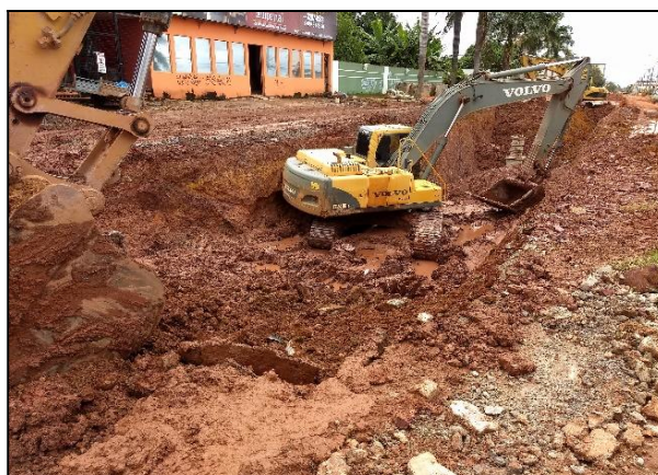
Figura 2: Erosão superficial do solo.
