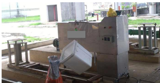
Fotografia 2 - Localização do equipamento na ETE
