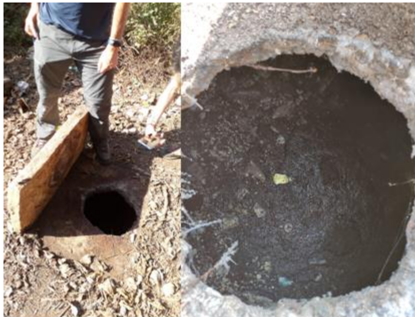
Figura 7 - Abertura de inspeção da Fossa Fonte: Autores (2022)
