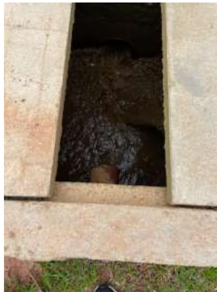
Figura 13 - Saída do sistema de lodo e interligação com lododuto.
