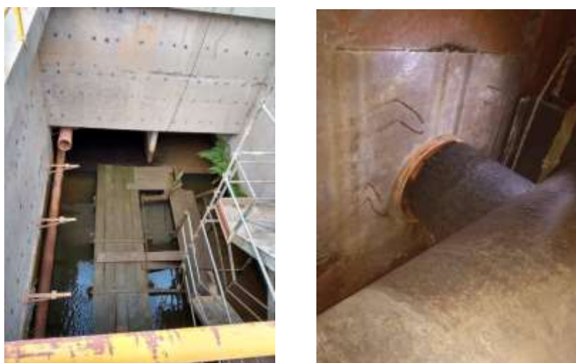
Figura 9 – Canalização do Córrego e Canalização do Sistema de retirada de lodo da ETA
