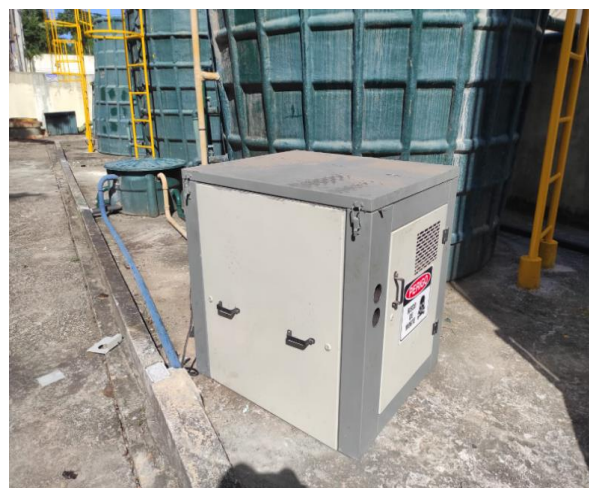
Figura 7 – Soprador de 8cv e pressão máx. de 550 MBAR instalado e bomba de recirculação ao fundo.
