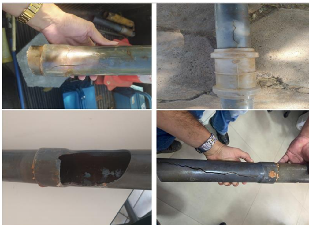
Figura 2: Trechos de tubos de água danificados do DMC-07.
