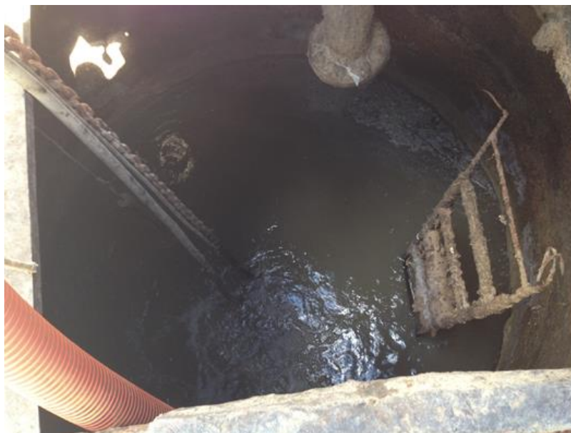
Figura 1 – Detalhe de uma escada marinheiro em aço carbono corroída no interior de uma estação elevatória de esgoto sanitário.
