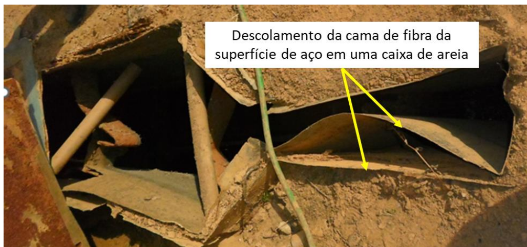
Figura 7 – Colapso da camada de proteção em PRFV em uma caixa de areia em aço
