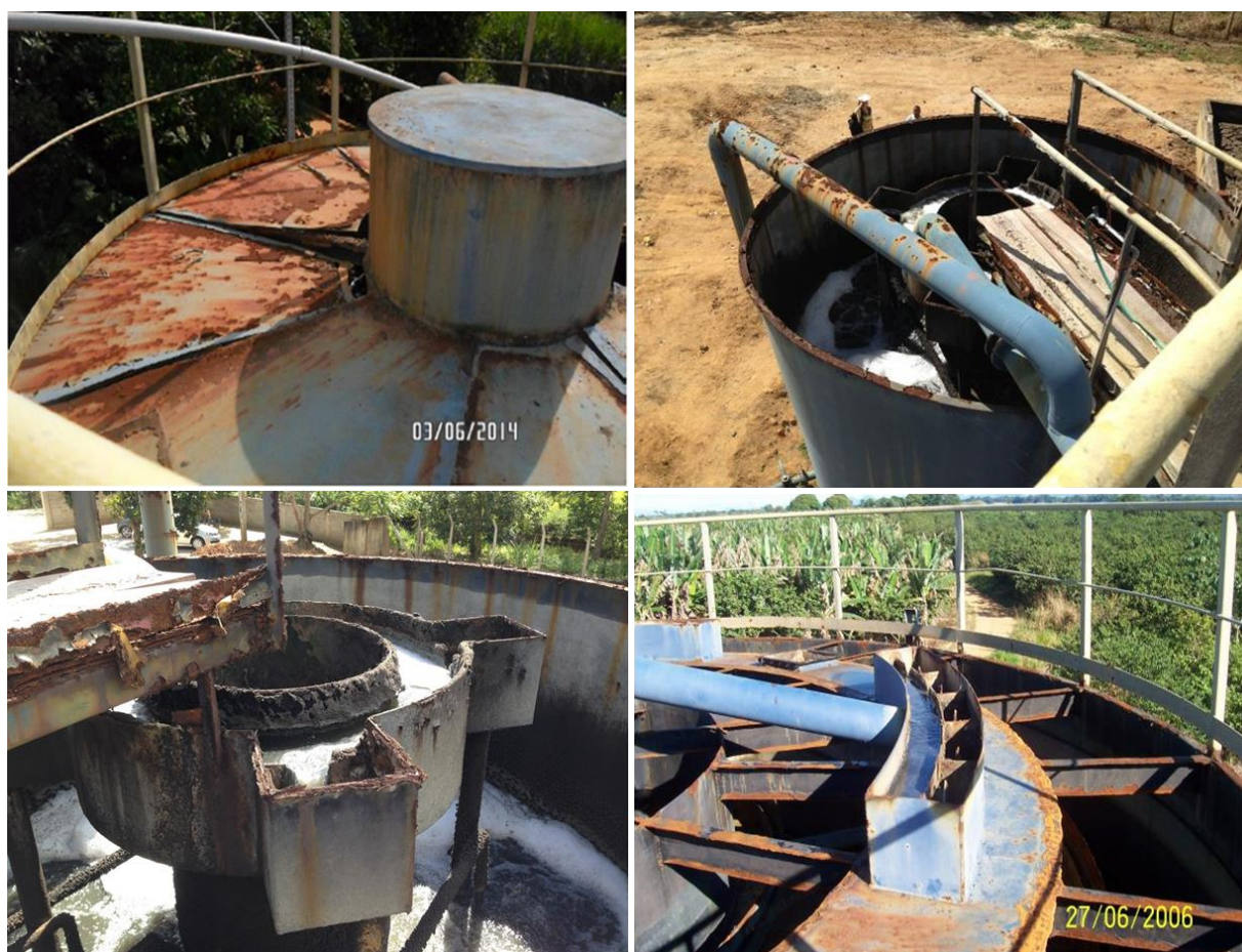
Figura 6 – O avanço da corrosão em ETEs compactas construídas com aço carbono
