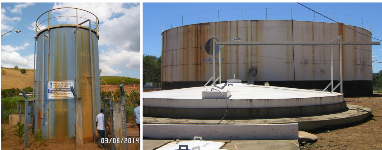
Figura 4 – Efeito da corrosão na parte externa de ETEs construídas com aço carbono
