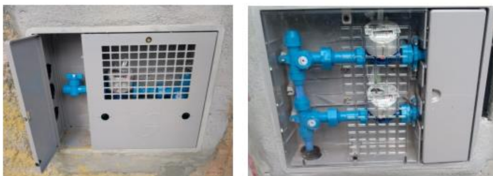
Figura 5 – Caixa UMA, instaladas em substituição aos antigos cavaletes de PVC
