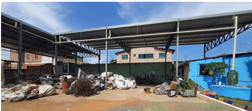
Figura 6: Galpão com grande abertura entre a alvenaria de vedação e a cobertura
