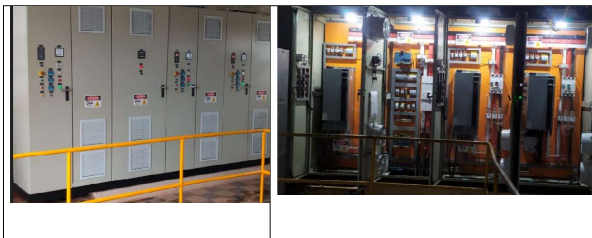
Figura 4 – Novo painel de acionamento
