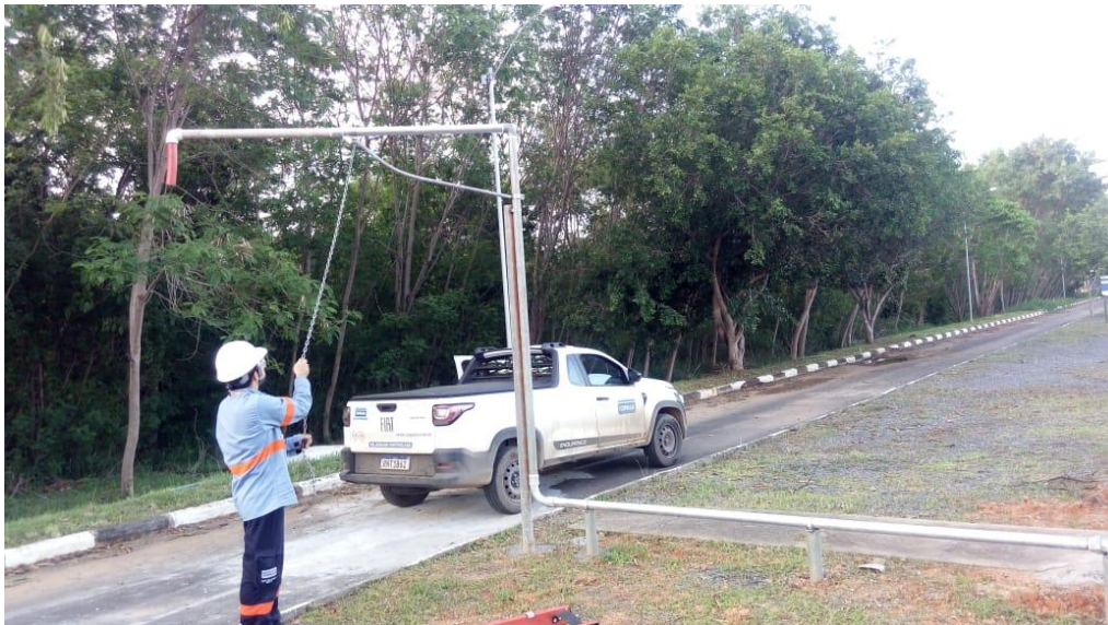
Figura 02: Ajuste da haste para o recebimento do caminhão pipa e aplicação da água de reúso
