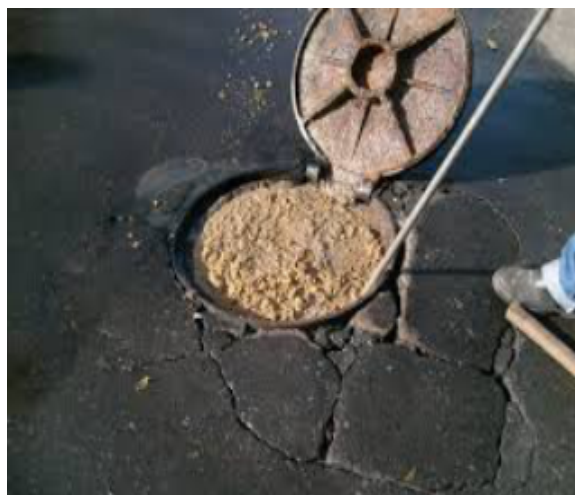
Figura 5 – Tubulação de esgoto obstruída
