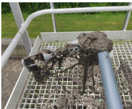
Figura 5: Sólidos acumulados na superfície do tubo PVC de suporte do sensor US na ETE Leeuwarden.
